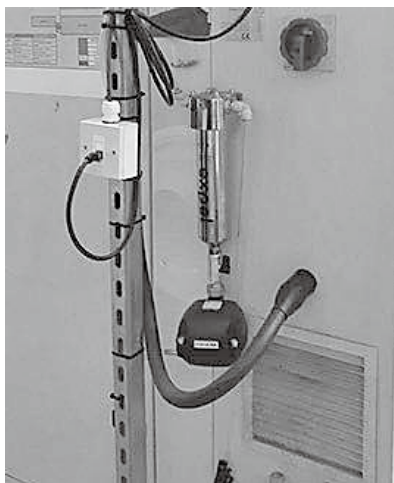
写真2 印刷機へのエア配管機器に設置したEXPEL
